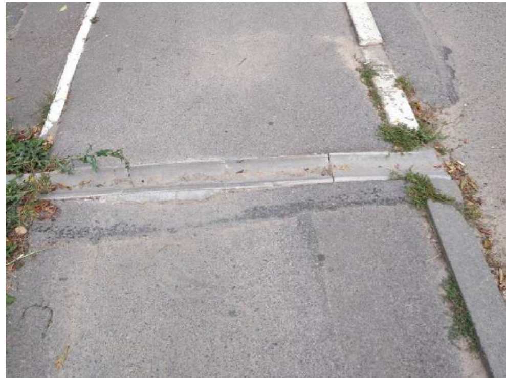
відкриті водовідвідні лотки (19%)
